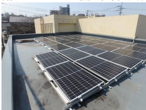
第三者所有モデルによる PV 設置（写真：日明市民センターの例）
