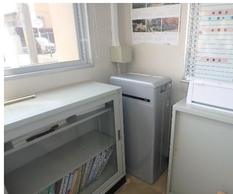
第三者所有モデルによる蓄電池の設置 (写真：日明市民センターの例)
